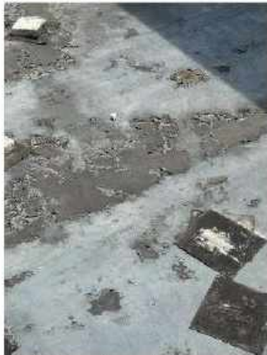
Fotografía N.3. Desgaste en el sistema de impermeabilización
